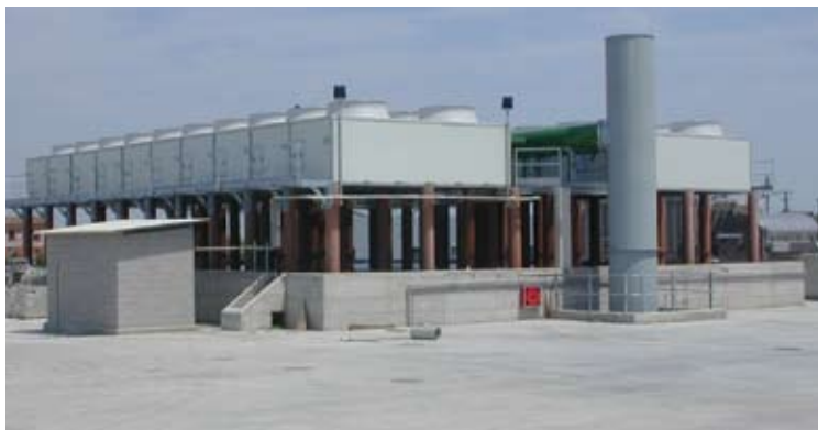
Le venti torri evaporative Mita adibite al raffreddamento dell'acqua dell'impianto di concentrazione di pomodoro
