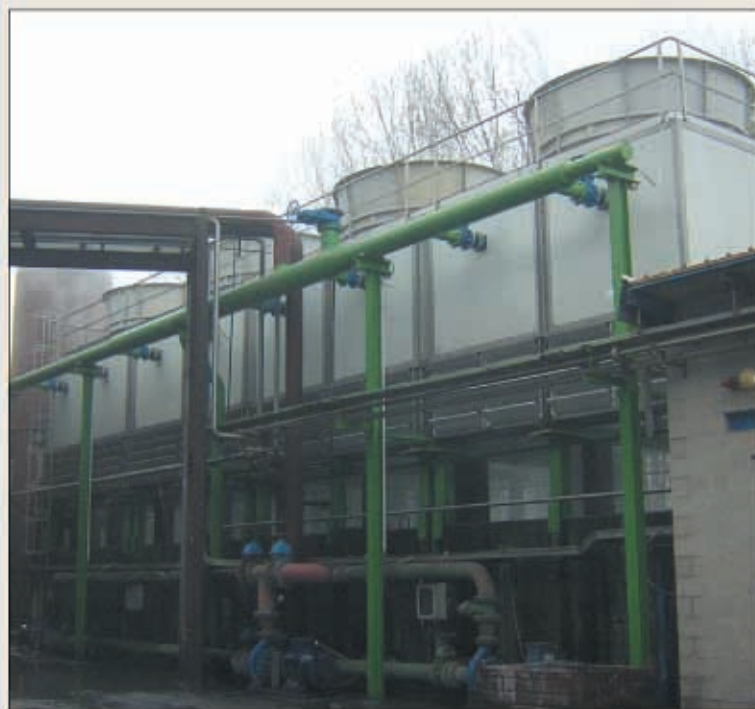
Impianto di filtrazione su sabbia
