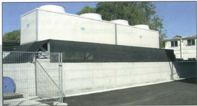
Due torri evaporative Mita, serie Pmp 6704 sono parte integrante del sistema installato nello stabilimento ASI-Ansaldo Sistemi Industriali di Monfalcone. Le torri sono caratterizzate da una potenzialità totale di 8.250.000 kcal/h e da una portata d'acqua complessiva di 566 m 3 /h
