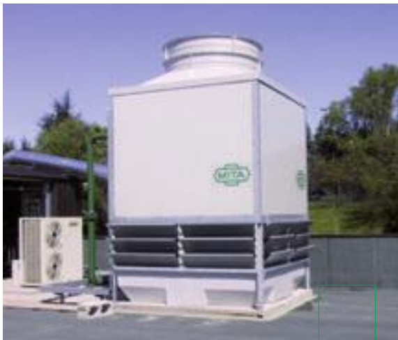
Torre di raffreddamento, modello PME 2404E nella versione Super Silent, montata nello stabilimento Ceratizit.
