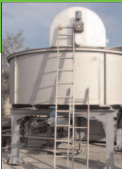
UN FLOTTATORE HA RISOLTO LE PROBLEMATICHE LEGATE ALLA CHIARIFICAZIONE DELLE ACQUE METEORICHE E DI FOGNATURA INTERNA PRIMA DELL'INVIO AL DEPURATORE COMUNALE
