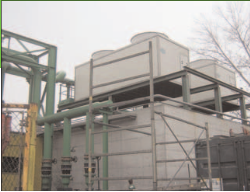
PRESSO LO STABILIMENTO DI PARONA SONO INSTALLATE NUMEROSE TORRI EVAPORATIVE MITA CHE CONSENTONO DI RECUPERARE IN CIRCUITO CHIUSO L'ACQUA UTILIZZATA PER IL RAFFREDDAMENTO
